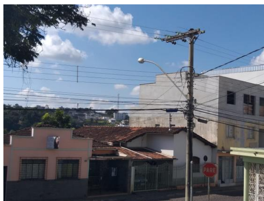
Figura 26 - Rede de fiação elétrica
