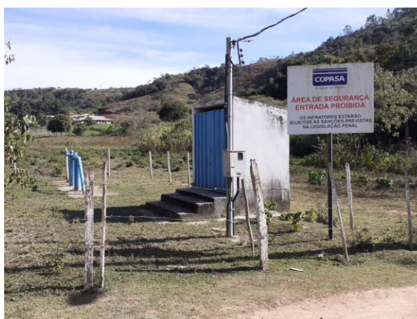
Figura 47 - Poço Artesiano localizado no bairro Boa Viagem
